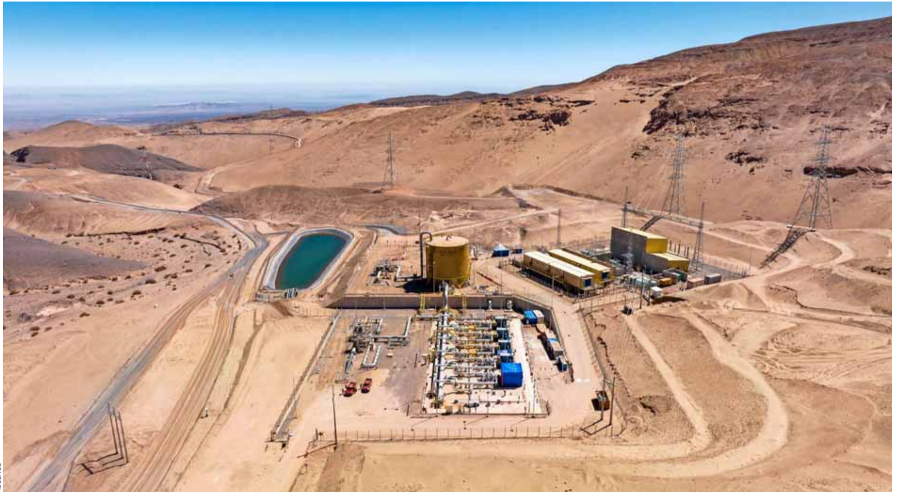
Estación de bombeo de Agua de Mar #4.
