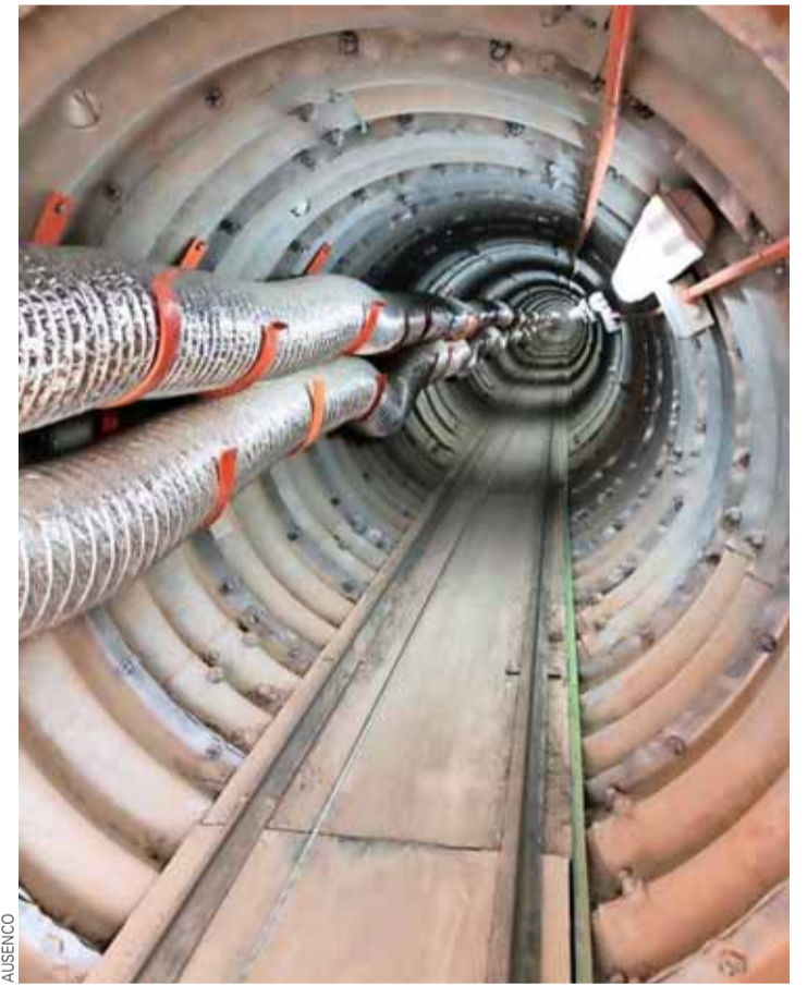
Atraveso subterráneo de líneas de alta tensión – Quebrada Huatacondo.
